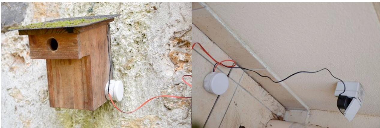
A gauche : nichoir équipé de la connexion 12V. A droite : alimentation secteur du transformateur 12V de la caméra.
