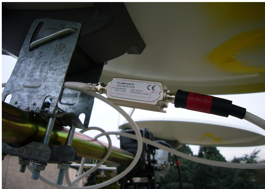
Figure 2: l'amplificateur en ligne 1 GHz utilisé environ 2m après le LNB. Nous l'avons installé sous l'antenne proche de l'axe de rotation en élévation.
